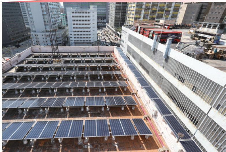
● 九巴屯門車廠天台已加裝太陽能板，繼續推動應用可再生能源，為建設綠色香港出一分力
